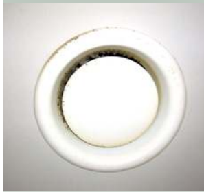
Schimmelbildung am Belüftungssystem
