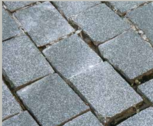
Verschobener Belag als Folge fehlender Fugenfüllung unter erhöhter Verkehrslast
