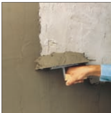
Wandflächen werden in dünnen Schichten mit Sopro ReparaturSpachtel, in dickeren Schichten mit Sopro AusgleichsMörtel Trass ausgebessert.
