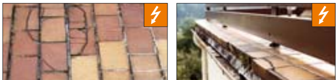
Solche Schäden verhindern Sie mit dem Schlüter®-Balkonsystem
